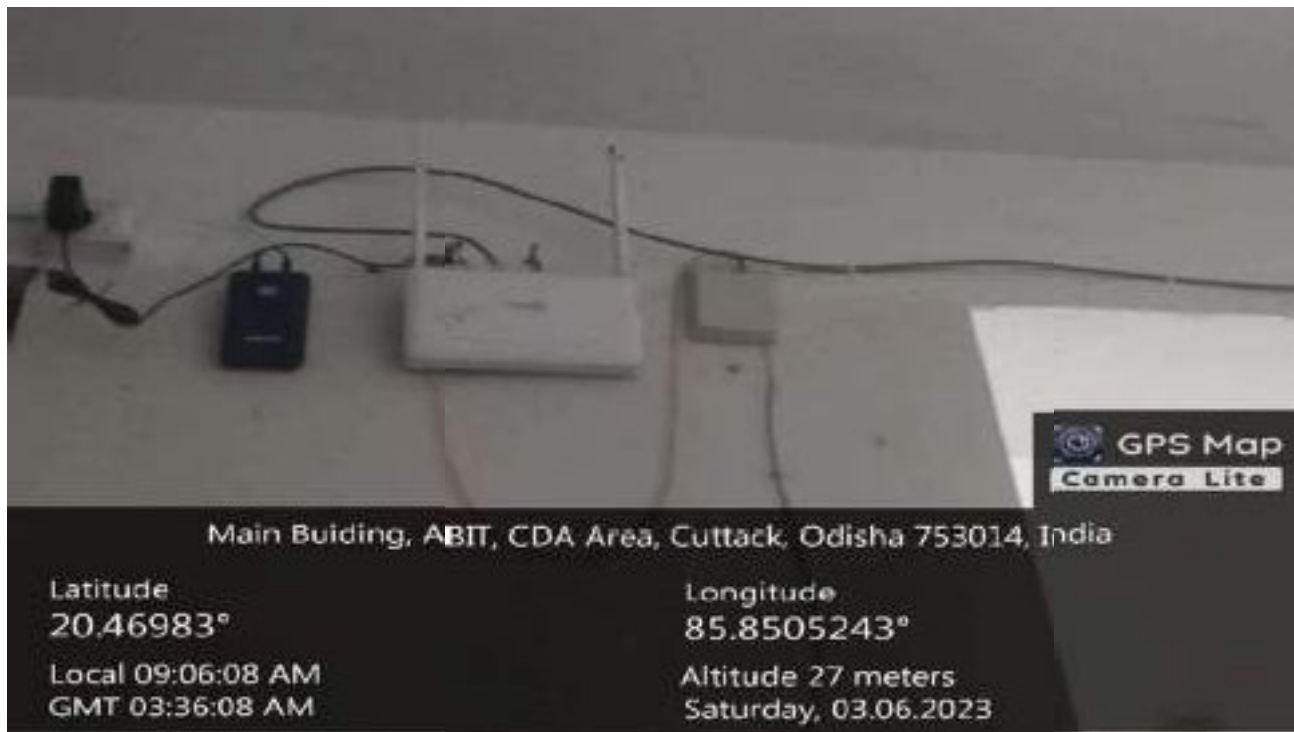
Wi - Fi Access Point
